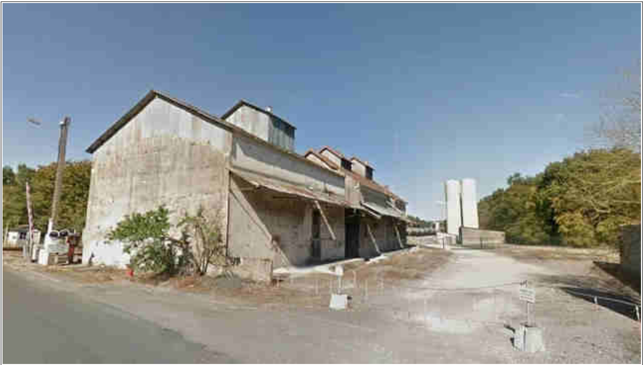
Bâtiments d'AXÉREAL désaffecté n°3 et n°4 à détruire (suspicion d'amiante liée en toiture)
